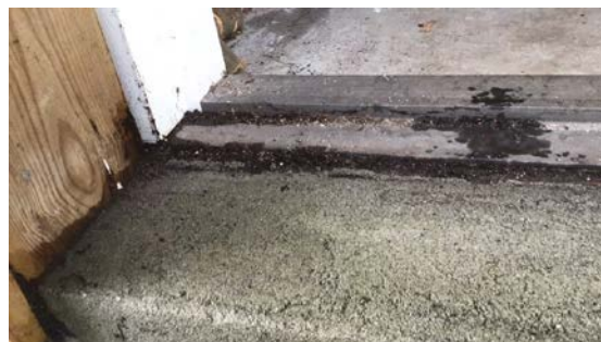
Kjellerdør med utettheter under dørsvill
