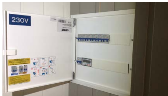
Sikringsskap i kjelleren
