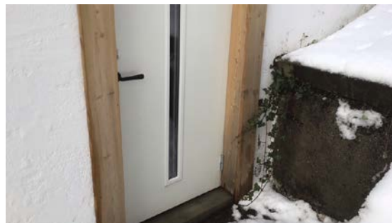
Utettheter mellom dørkarm og dørblad på kjellerdør
