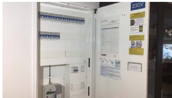
Sikringsskap i 1 etg
