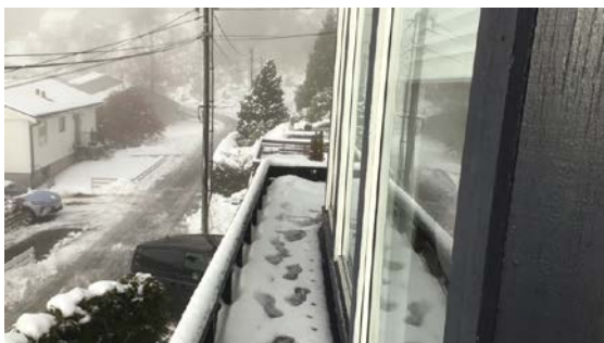
Rekkverk rundt tilbygget av meget lav høyde
