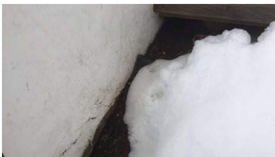
Ikke registrert fuktsikring langs grunnmur
