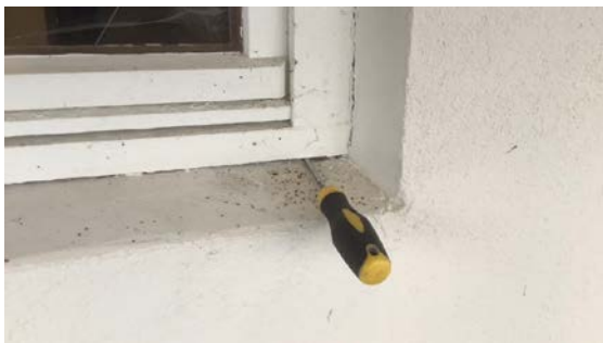
Utettheter i underkant kjellervinduer
