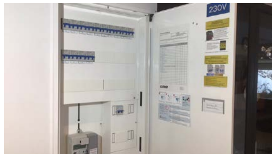
Sikringsskap i 1 etg
