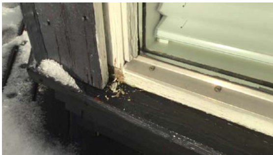
Fukt merker i stuevinduer i tilbygget
