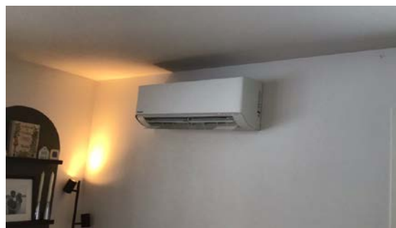
Varmepumpe i stue
