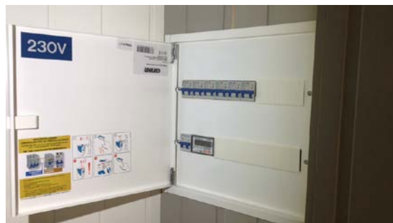
Sikringsskap i kjelleren
