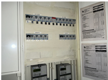
Automatsikringer i felles sikringsskap plassert i gang/fellesareal.
