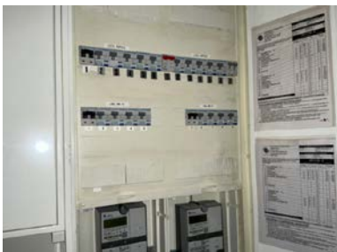
Automatsikringer i felles sikringsskap plassert i gang/fellesareal.
