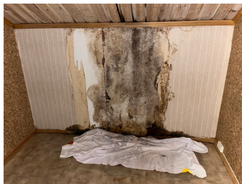
Fuktskader i vegg, gulv og tak
