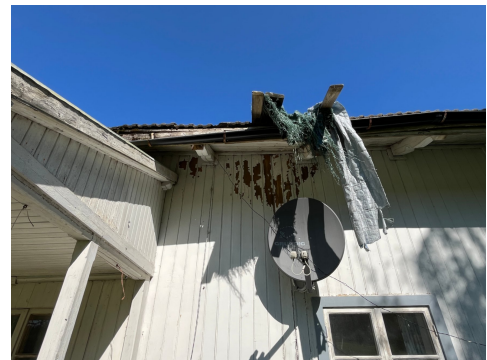
Deformasjoner på takrenne
