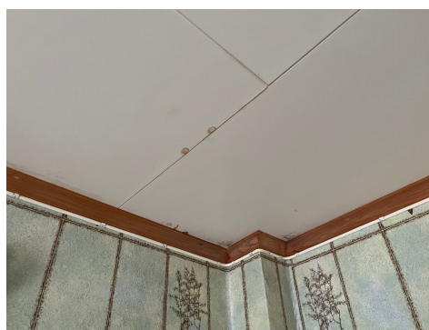
Fuktskade i tak på vaskerom
