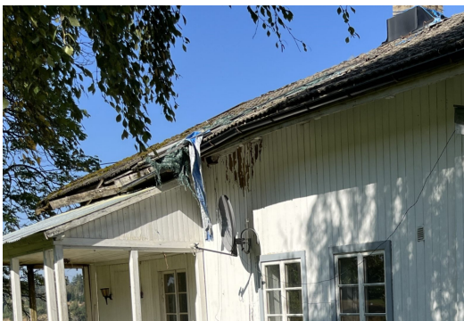
Manglende og ødelagt takstein
