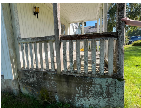
Råteskader i trekonstruksjoner
