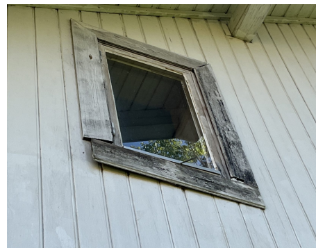
Dårlig tetting rundt vindu
