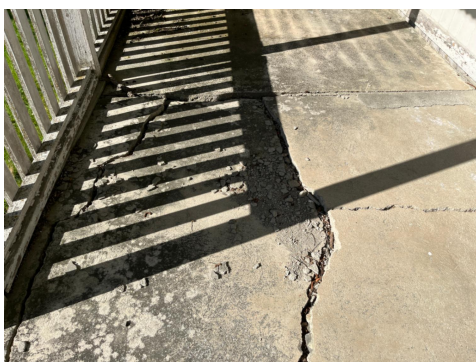
Sprekker i betonggulv
