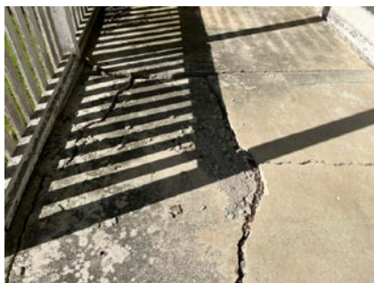
Sprekker i betonggulv
