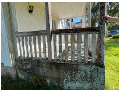
Råteskader i trekonstruksjoner
