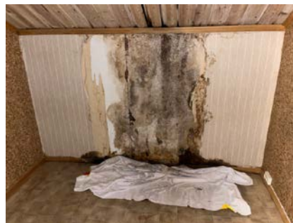
Fuktskader i vegg, gulv og tak
