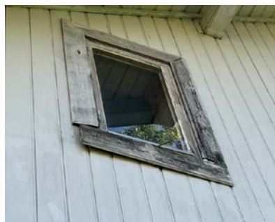
Dårlig tetting rundt vindu
