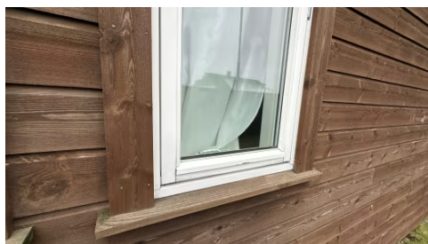
Registrert råte i vindu på soverom øst
