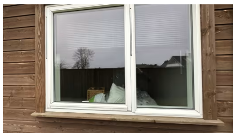
Registrert råte i vindu på bad øst
