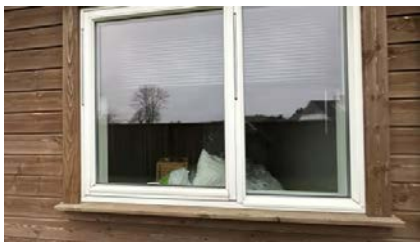
Registrert råte i vindu på bad øst
