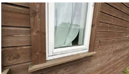
Registrert råte i vindu på soverom øst
