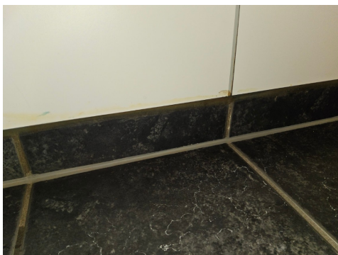
Fuktpåvirket baderomsplater i plateskjøt i dusjsone
