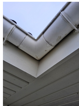
Mindre lekkasje ved rennevinkel/skjøt
