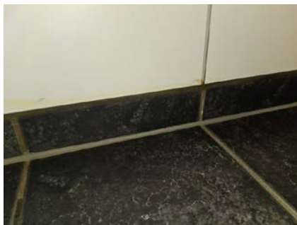
Fuktpåvirket baderomsplater i plateskjøt i dusjsone
