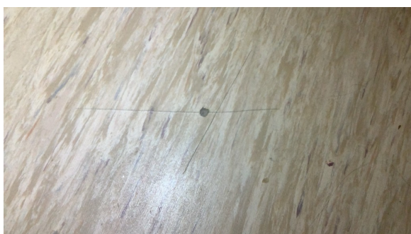
Riper og skade i vinylbelegg.
