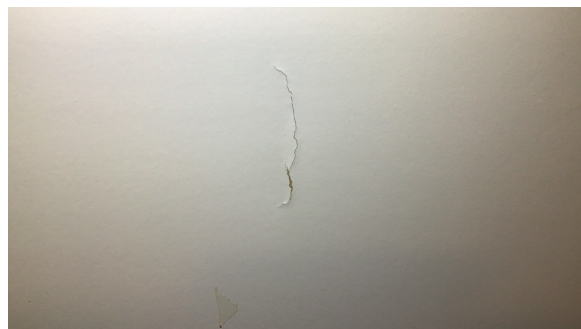
Skade i dørblad.
