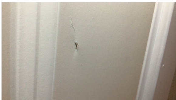
Skade i dørblad.
