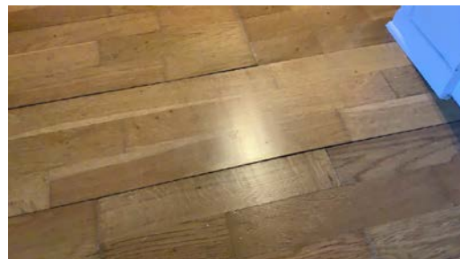
Sprekker i parkett som kan minne om svellskader.
