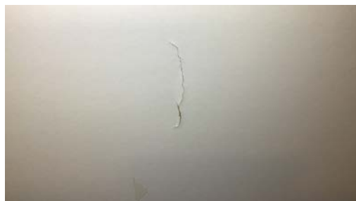
Skade i dørblad.
