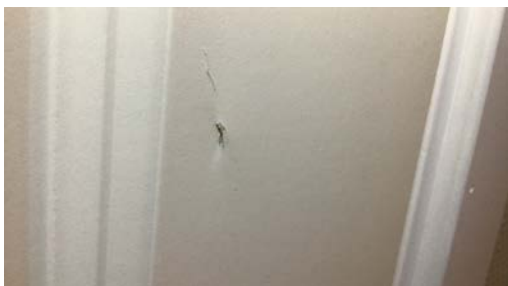
Skade i dørblad.
