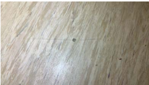
Riper og skade i vinylbelegg.
