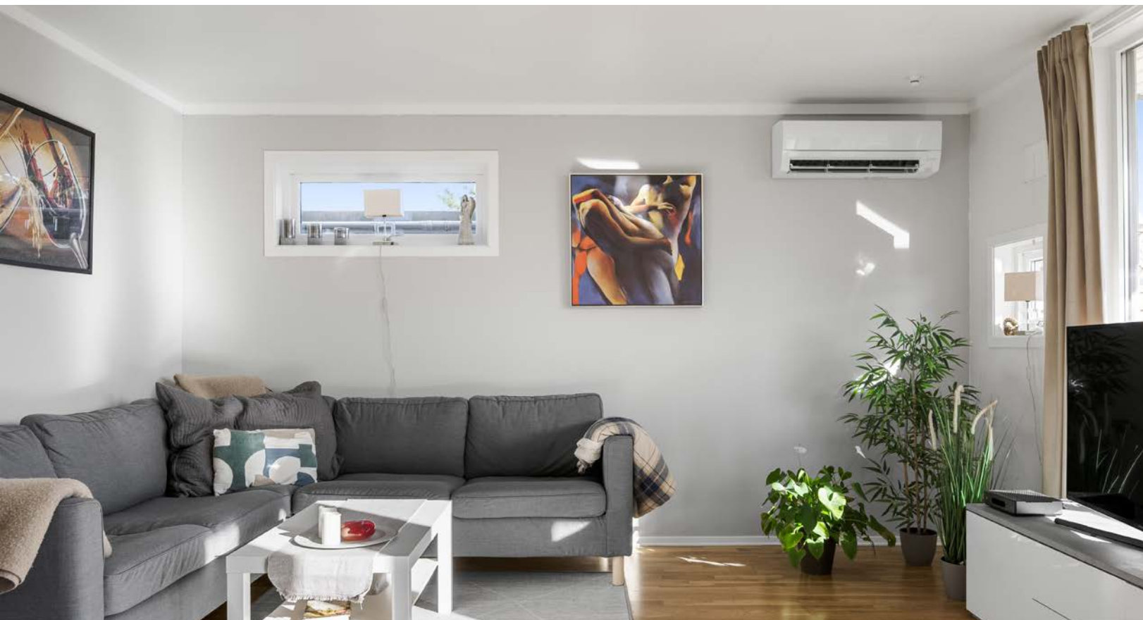
Møbleringsvennlig stue og varmepumpe som var ny i 2024.
