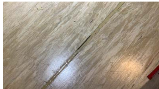
Sprekker i sveiseskjøt.
