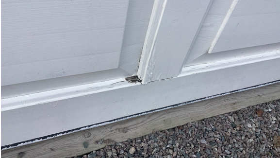
Begynnende råteskade på port.
