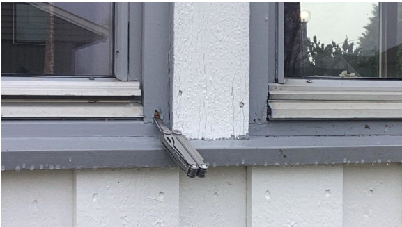
Råte i vinduer mot nord.
