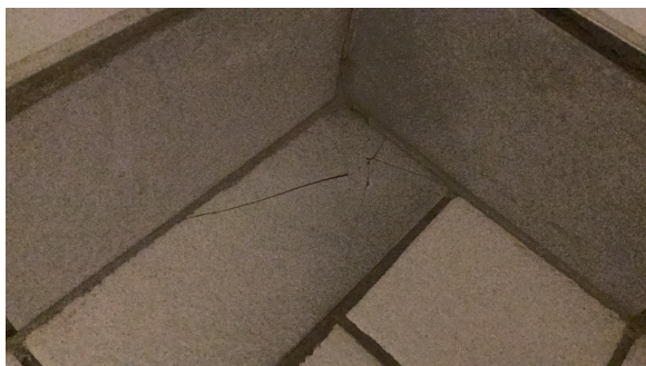
Sprekk i gulvflis.
