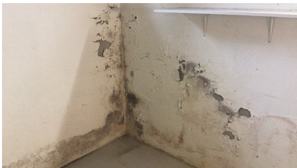
Eksempel på fuktpåkjenning og avskaling på murvegg
