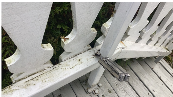
Eksempel på råte i rekkeverk ved entre.
