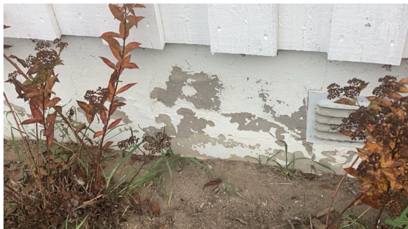
Eksempel på avskalinger på grunnmur.
