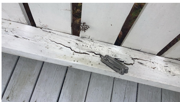
Eksempel på råte i rekkeverk på hovedveranda.
