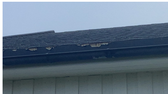
Eksempel på avskaling på beslag.
