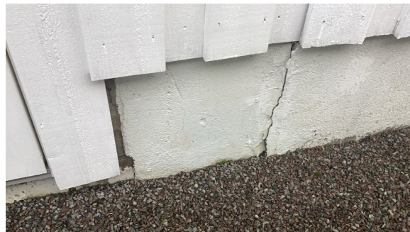
Eksempel på sprekk i grunnmur.
