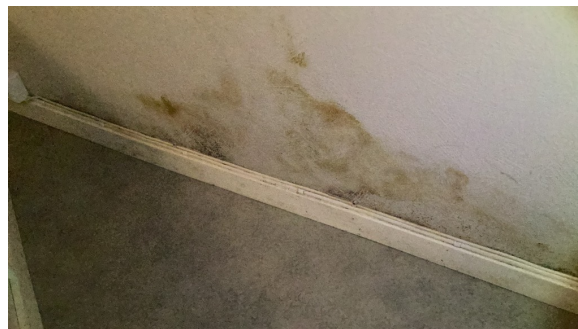
Eksempel på synlig fuktpåkjenning på utforet vegg mot terreng.
