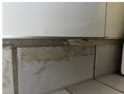
Eksempel på grov fuging.
