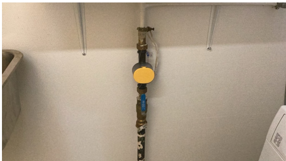
Vanninntak med måler og stoppekran.
