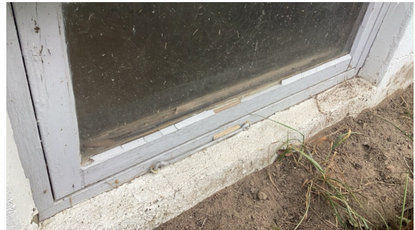
Eksempel på tilstand på kjellervindu.
