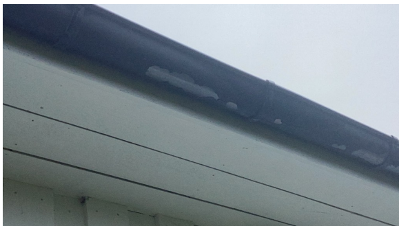
Eksempel på avskaling på takrenne.
