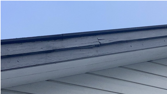
Slitasje og mulig råte på vindski
