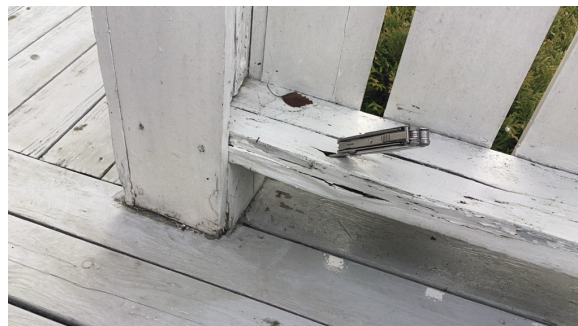
Eksempel på råte i rekkeverk på hovedveranda.
