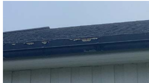
Eksempel på avskaling på beslag.
