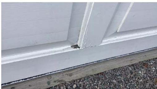
Begynnende råteskade på port.
