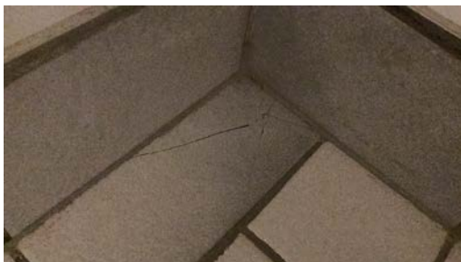
Sprekk i gulvflis.
