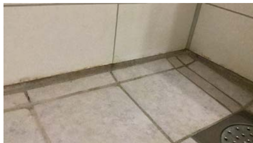
Baderomsplater er ikke montert iht. montasjeanvisning.
