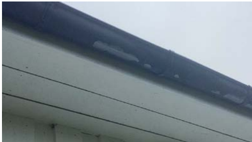
Eksempel på avskaling på takrenne.
