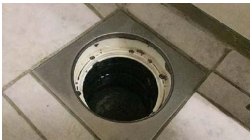
Det er ikke synlig tegn til membran på gulv ved sluk.
