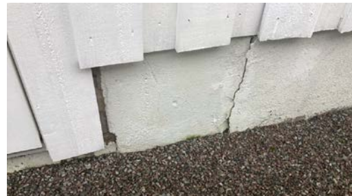
Eksempel på sprekke i grunnmur.
