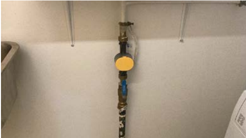
Vanninntak med måler og stoppekran.
