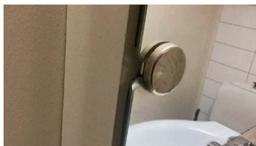
Det er noen mindre skader på speil.
