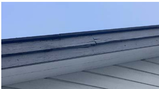
Slitasje og mulig råte på vindski
