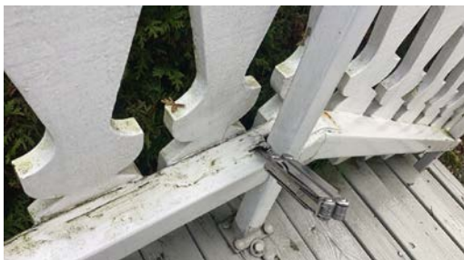
Eksempel på råde i rekkverk ved entre.
