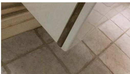
Lamell på innredning er løs.
