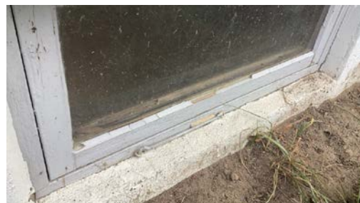
Eksempel på tilstand på kjellervindu.
