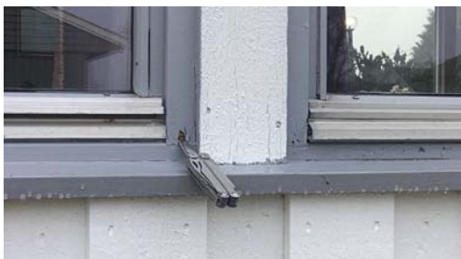
Råte i vinduer mot nord.
