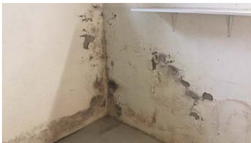
Eksempel på fuktpåkjenning og avskaling på murvegg
