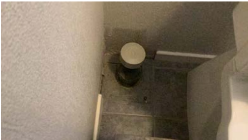
Lufting av avløp med ventil på toalettrom.
