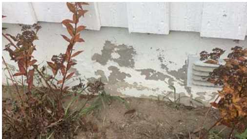
Eksempel på avskaling på grunnmur.
