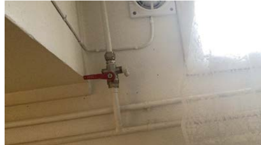
Stoppekran for vann til utekran
