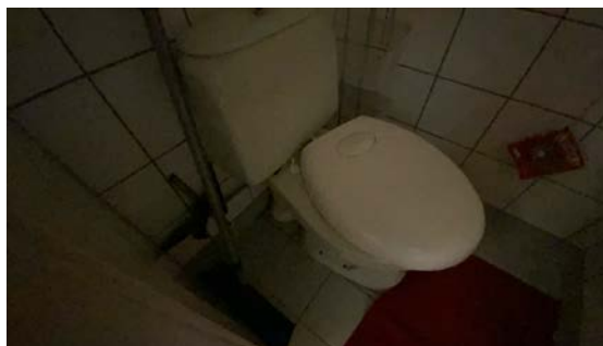
Defekt toalett (nytt er innkjøpt, men ikke montert)
