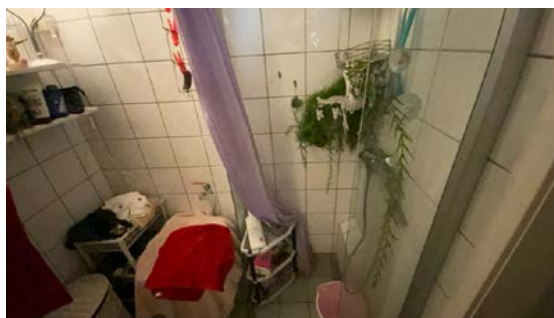
Dusjvegger mangler skyvedørene.
