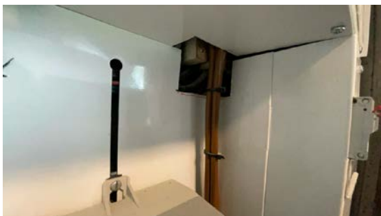
Berøringsfare, mangler tildekning.
