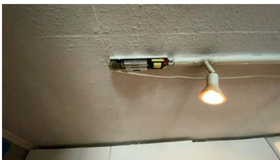
Svimerker ved spottskinne og omdormer i tak på
