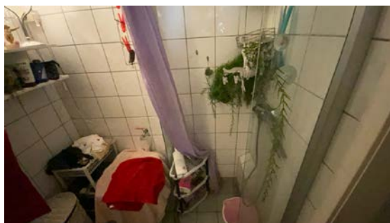
Dusjvegger mangler skyvedørene.
