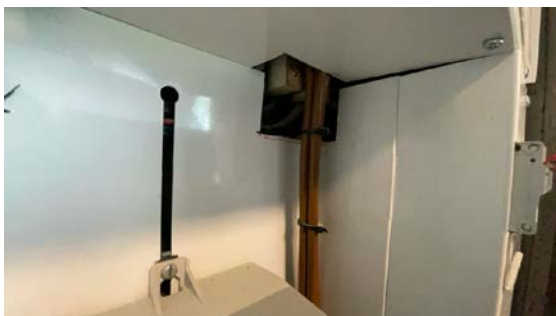
Berøringsfare, mangler tildekning.
