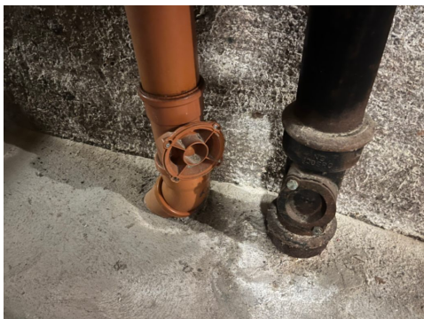
Avløpsrør av plast og støpejern med stakeluger.
