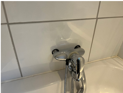
Gjennomføring i vegg ved badekar er ikke tett.
