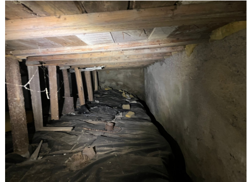
Krypkjeller med provisorisk understøttelser av bjelkelag.
