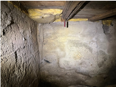
Råte i bjelker og saltutslag på vegger.
