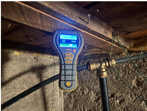
Fuktmålinger viste normal fukt i trevirke.
