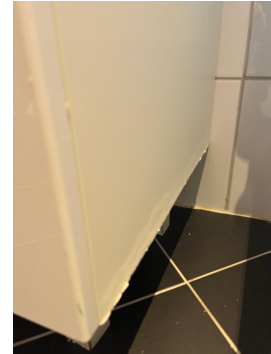
Servantskap har noe fuktskade i nedkant.
