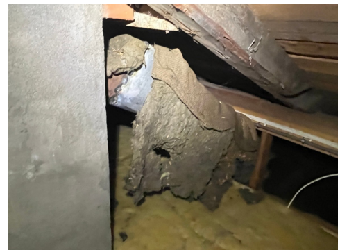
Kanal på loftet må isoleres.
