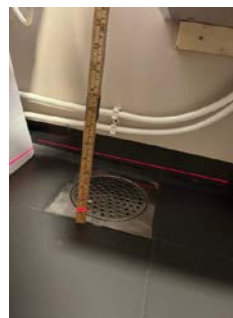
Måling av fall ved sluk viste tilsvarende 30 mm.
