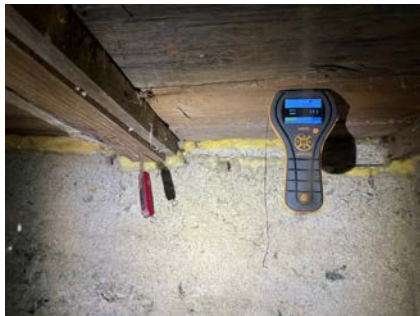
Fuktmåling viste over grensen til skadelig fukt.
