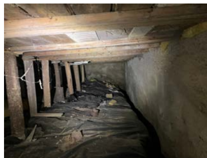
Krypkjeller med provisorisk understøttelser av bjelkelag.
