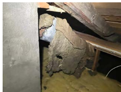
Kanal på loftet må isoleres.
