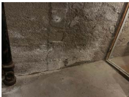
Saltutslag på vegger, som er tegn på fukt.
