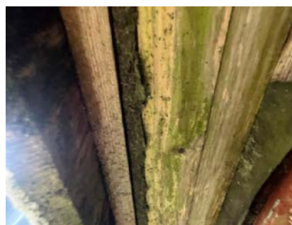
Bilde underkant av kledning på eldre del.
