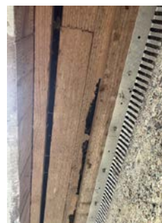
Bilde underkant av kledning på tilbygg.
