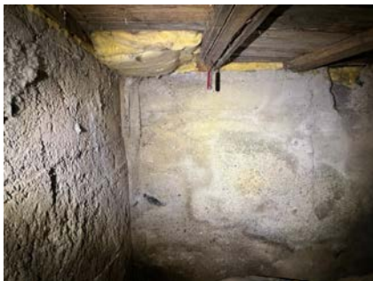
Råte i bjelker og saltutslag på vegger.
