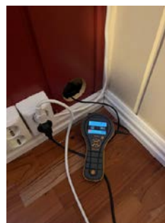
Fuktmåling viste skadelig fukt i utforet vegg.
