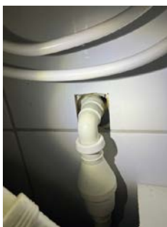
Gjennomføring i vegg under servant er ikke tett.
