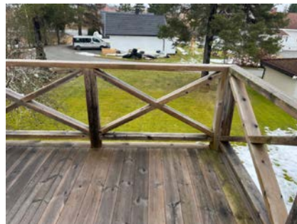
Rekkverk på veranda bør utbedres til dagens krav.
