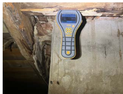
Fuktmåling ved pipe viste normale verdier.
