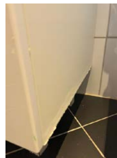
Servantskap har noe fuktskade i nedkant.
