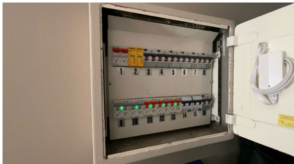
Sikringskap plassert på soverom.
