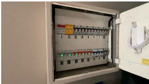
Sikringskap plassert på soverom.
