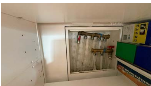
Rørskap på bad
