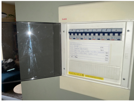
Automatsikringer i sikringskap plassert i entre
