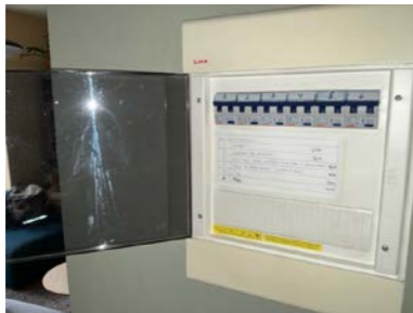
Automatsikringer i sikringsskap plassert i entre
