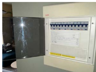
Automatsikringer i sikringsskap plassert i entre
