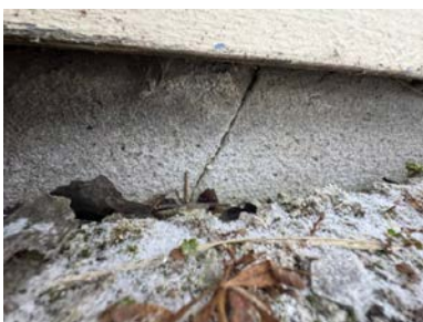
Eksempel på sprekk i murpussen.
