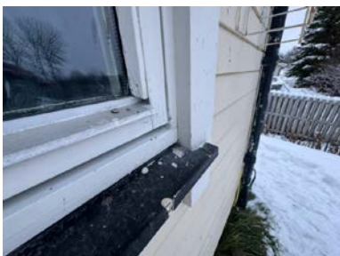
Eksempel på værslitt vindu.
