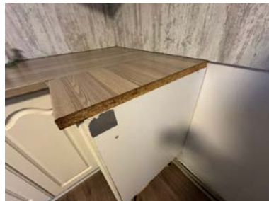
Eksempel på hvor det ikke er montert kantlist.
