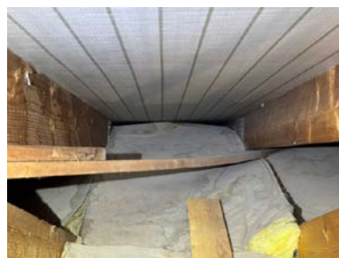
Eksempel på begrenset ventilering og tegn til begrenset ventilering.
