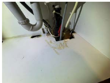
Fuktsvelling i bunnplaten i benkeskap.
