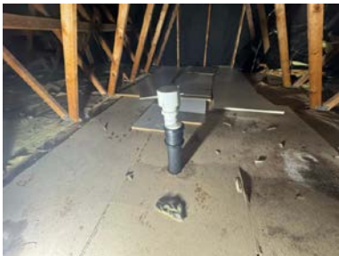
Vakuumventil på loftet.
