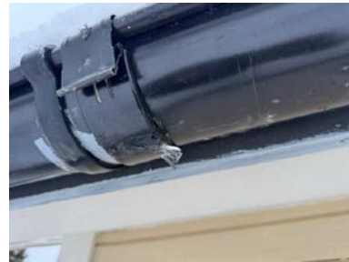
Tegn til punktvis lekkasje.
