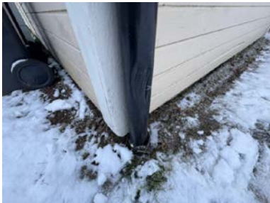
Eksempel på bulker i takrennenedløpet.
