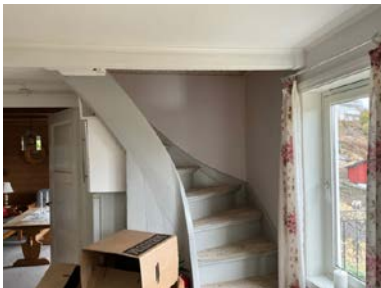
Trapp mangler rekkverk og håndløper. Se egne punkt under HMS-avvik.
