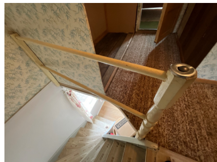
Løst rekkverk og større åpninger. Se eget punkt under HMS-avvik
