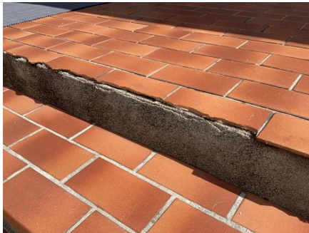
Flere skader på gulvfliser på trapp.
