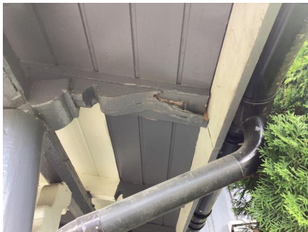
Slitasje og oppsprekking på sperre på veranda ved entre.
