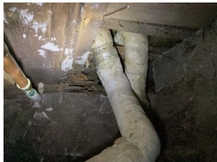
Gammel råteskade er observert på ett sted.
