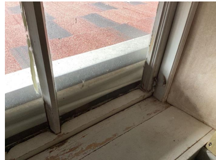
Beslag mellom vegg og tak over innglasset veranda er lagt utenpå kledning og går forbi vinduer.
