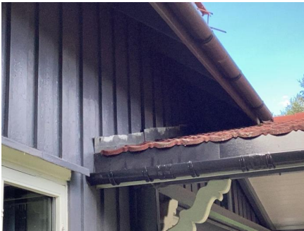
Beslag/papp i overgang mellom tak og vegg over entre er lagt utenpå kledning. Løsningen fremstår ikke tett.
