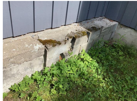
Det er noen sprekker i grunnmur.
