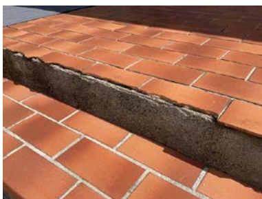
Flere skader på gulvfliser på trapp.
