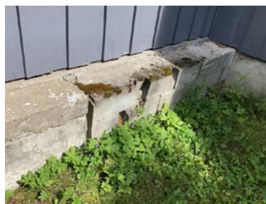
Det er noen sprekker i grunnmurer.
