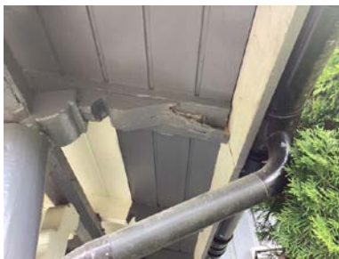
Slitasje og oppsprekking på sperre på veranda ved entre.
