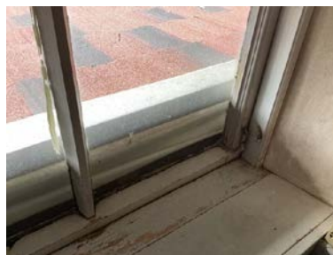
Beslag mellom vegg og tak over innglasset veranda er lagt utenpå kledning og går forbi vinduer.
