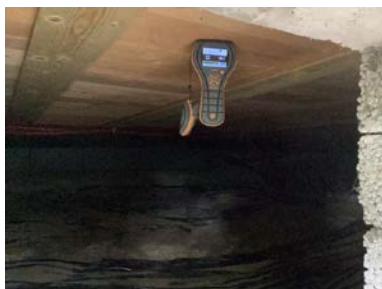
Fuktmåling i kryperom i tilbygg.
