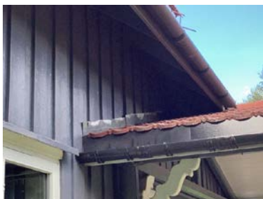
Beslag/papp i overgang mellom tak og vegg over entre er lagt utenpå kledning. Løsningen fremstår ikke tett.
