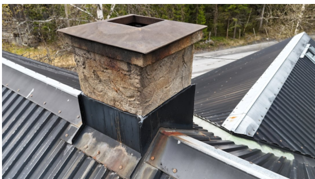
Påvist rustdannelse i pipebeslag.
