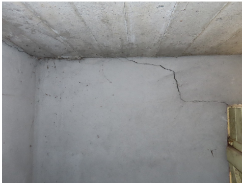
Sprekkdannelse i mur pga jordtrykk.
