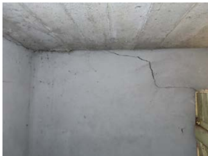
Sprekkdannelse i mur pga jordtrykk.
