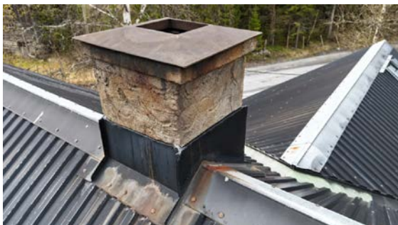
Påvist rustdannelse i pipebeslag.
