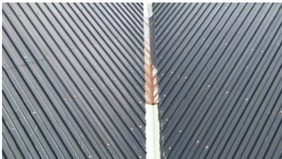
Påvist rustdannelse i kilrennebeslag.
