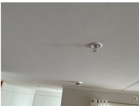
Røykvarslere og sprinkeldyse i stuetak
