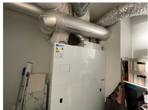
Ventilasjonsanlegget i boden
