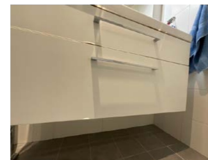
Svelling etter fuktighet på innredning
