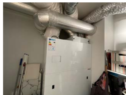
Ventilasjonsanlegget i boden
