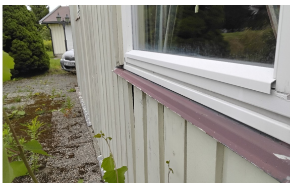
Dårlig montert beslag under vindu.
