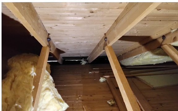
Isolasjon som har falt ned og liten lufting ved takfot
