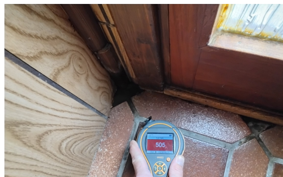
Fukt utslag på gulvet innenfor døren
