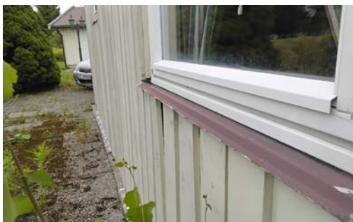
Dårlig montert beslag under vindu.
