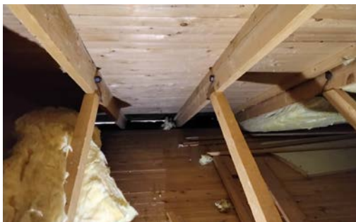
Isolasjon som har falt ned og liten lufting ved takfo
