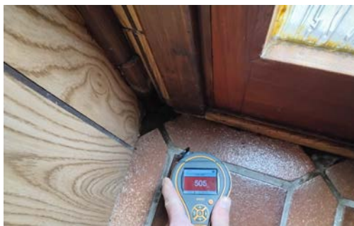
Fukt utslag på gulvet innenfor døren
