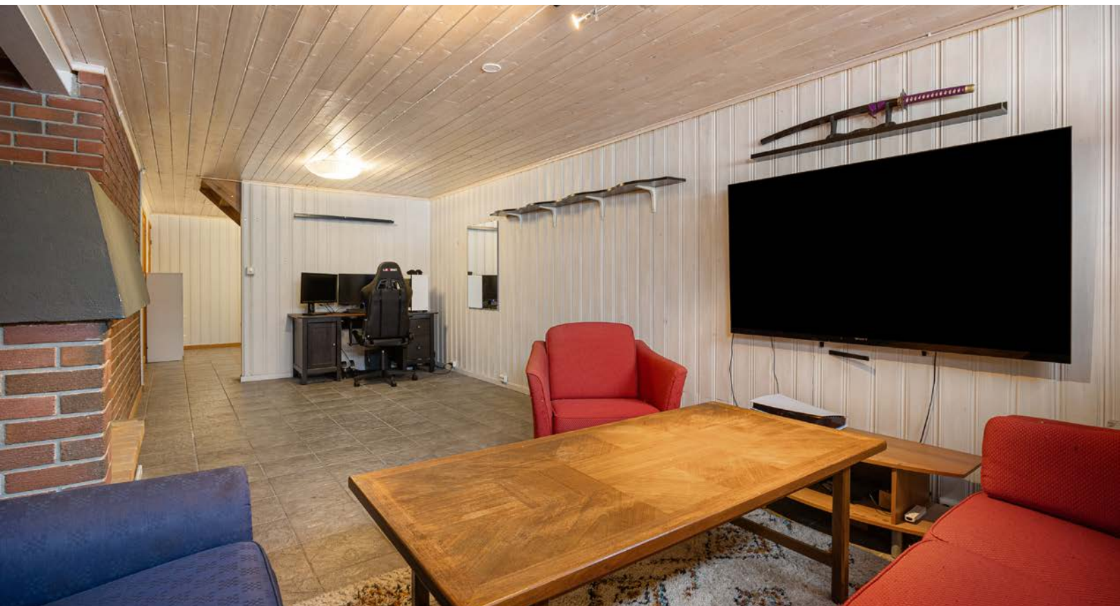
Rommet er betegnet som hobbyrom på byggetegninger og det er ikke søkt godkjenning av bruksendringen. Rommet kan derfor ikke lovlig brukes som oppholdsrom, og tilfredsstillende heller ikke kravene til lysforhold eller rømningsvei.
