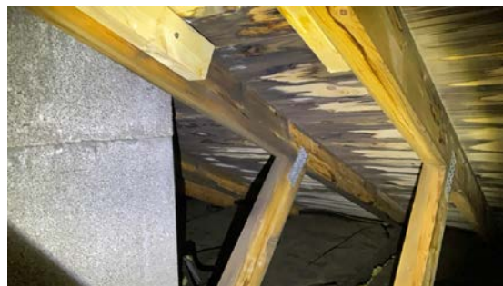
Skade i undertaket etter tidligere lekkasje ved pipen.
