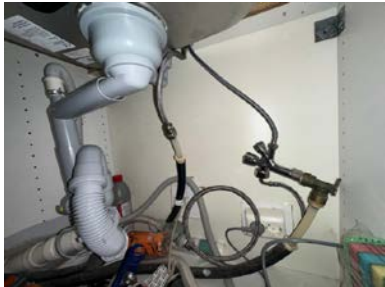
Rørproplegg i kjøkkenbenk
