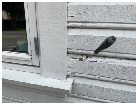
Betydelige råteskader mot veien.
