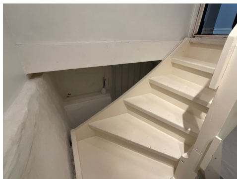
Store åpninger i rekkverk.
