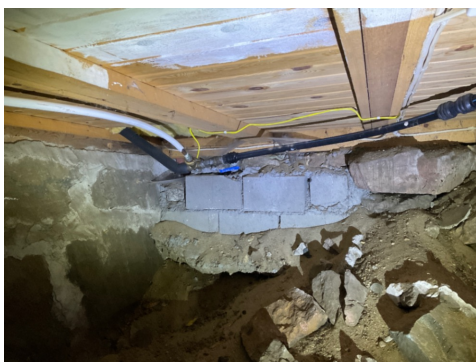
Vann inntak med stoppekran. Vannrør av kobber.
