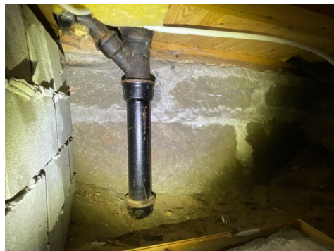
Avløp av støpejern.
