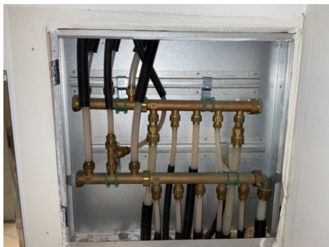
Vannskap i tilbygg.
