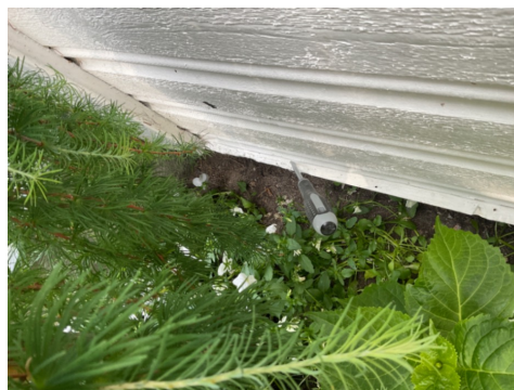
Mindre råteskade i bunnstokk ved inngangsdør.
