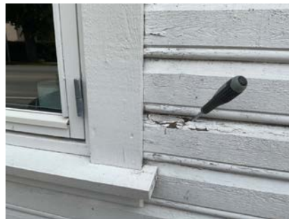
Betydelige råteskader mot veien.
