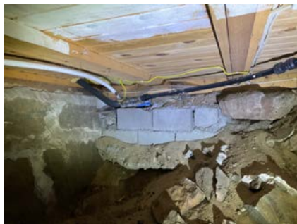
Vann inntak med stoppekran. Vannrør av kobber.
