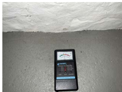
Fuktsøk i kjeller
