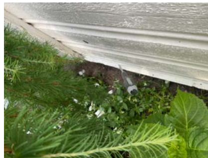
Mindre råteskade i bunnstokk ved inngangsdør.
