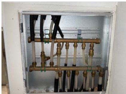
Vannskap i tilbygg.
