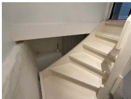
Store åpninger i rekkverk.
