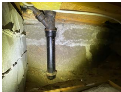
Avløp av støpejern.
