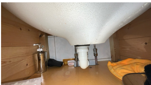
Del av rør til avløp.
