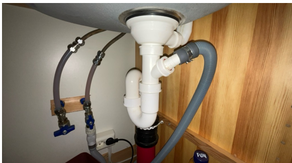
Del av rør til avløp.
