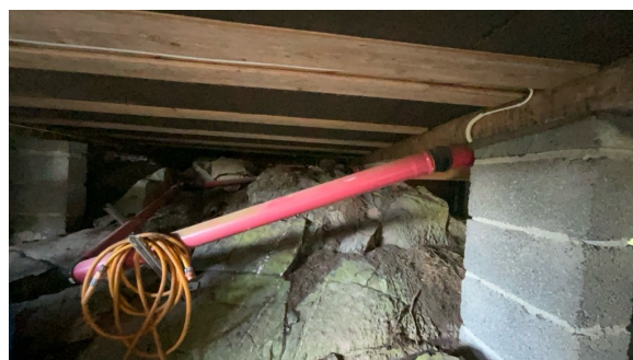
Del av rør til avløp.
