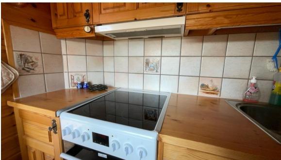
Montert avtrekk over komfyr.
