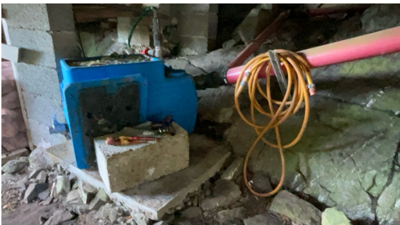
Tank med kværnepumpe.
