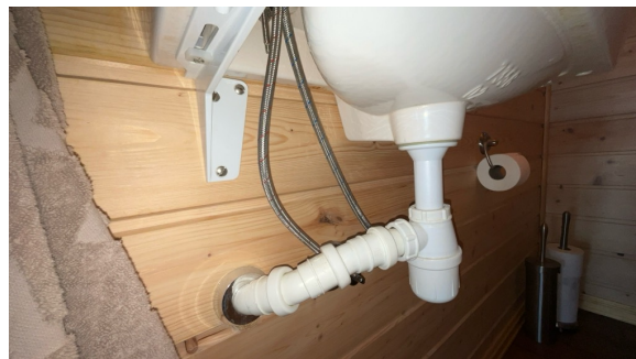
Del av rør til avløp.
