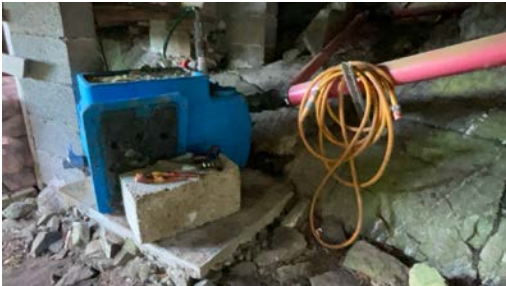
Tank med kværnepumpe.
