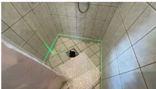
Målt fall på gulv.
