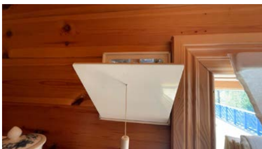
Eksempel på montert ventil i vegg.
