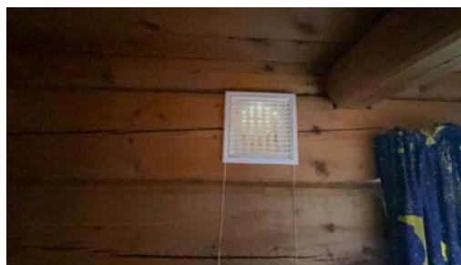
Eksempel på montert ventil i vegg.
