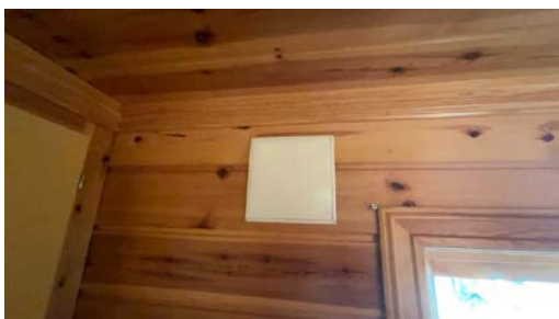
Eksempel på montert ventil i vegg.
