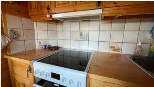
Montert avtrekk over komfyr.
