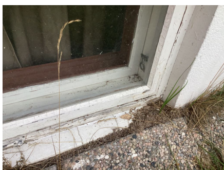
Eksempel på slitasje på vindu.
