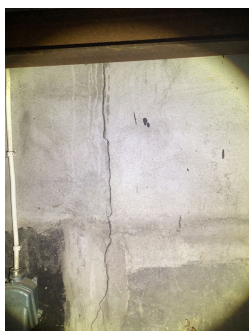
Eksempel på sprekk i grunnmur.
