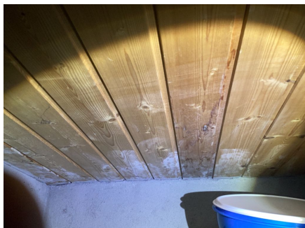
Fuktmerker i himling på ett bodrom.
