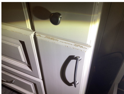
Eksempel på slitasje.
