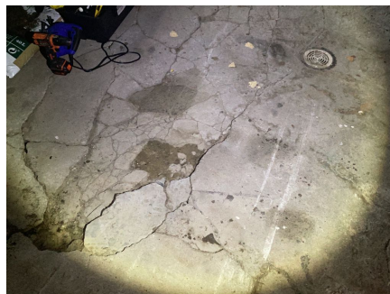
Oppsprekking i gulv i garasje.
