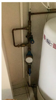
Vanninntak med måler og stoppekran.
