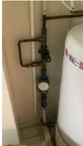
Vanninntak med måler og stoppekran.
