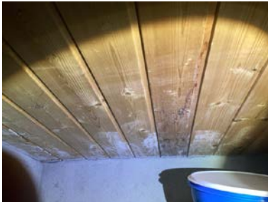
Fuktmerker i himling på ett bodrom.
