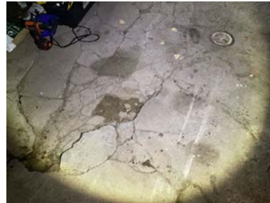
Oppsprekking i gulv i garasje.
