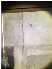
Eksempel på sprekk i grunnmur.
