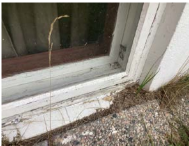
Eksempel på slitasje på vindu.
