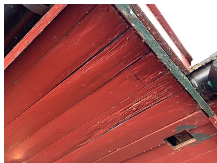
Råte i gesimskledning.
