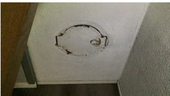
Sotluke på kontor.
