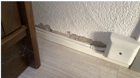
Avskaling på murvegg.
