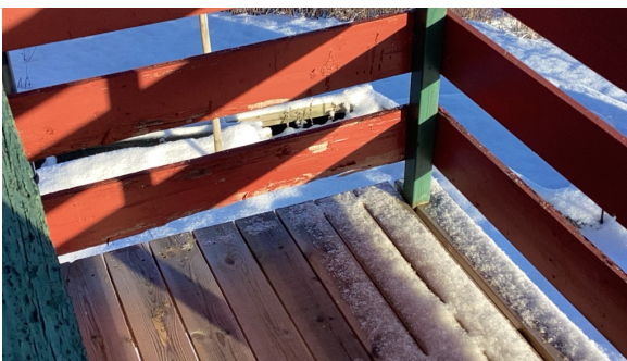
Råte på rekkverkskledning på balkong.
