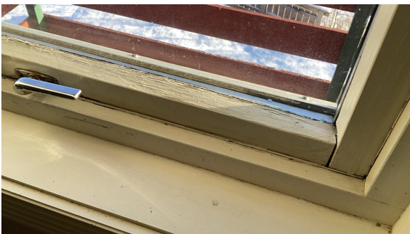
Eksempel på innvendig slitasje.
