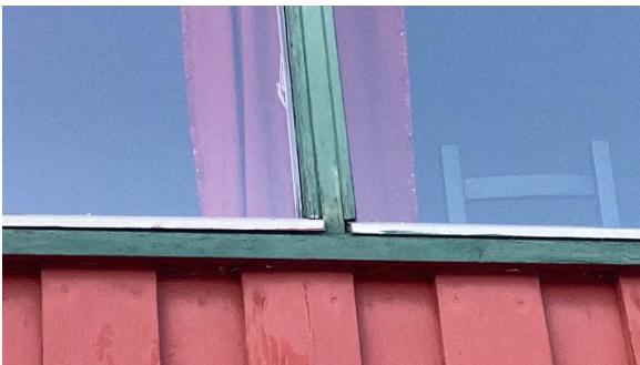
Eksempel på utvendig slitasje.
