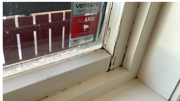
Eksempel på innvendig slitasje.
