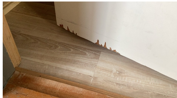
Eksempel på slitasje.
