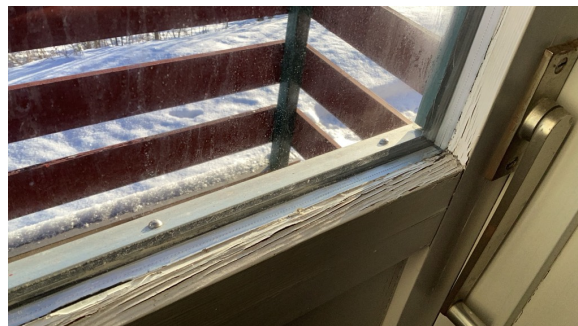
Slitasje på balkongdør.
