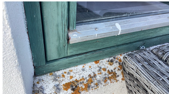
Eksempel på utvendig slitasje.
