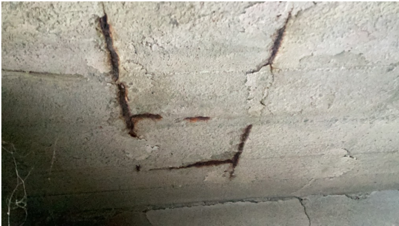
Avskaling og synlig armering under hovedveranda.
