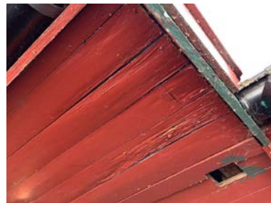
Råte i gesimskledning.
