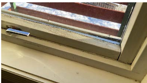
Eksempel på innvendig slitasje.
