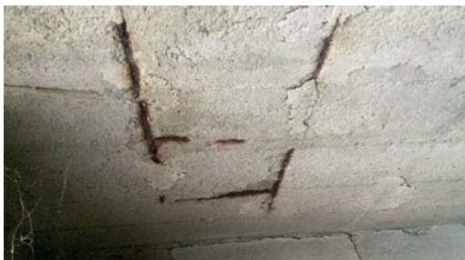
Avskaling og synlig armering under hovedveranda.
