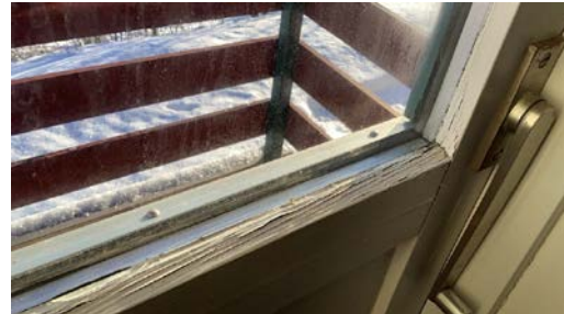
Slitasje på balkongdør.
