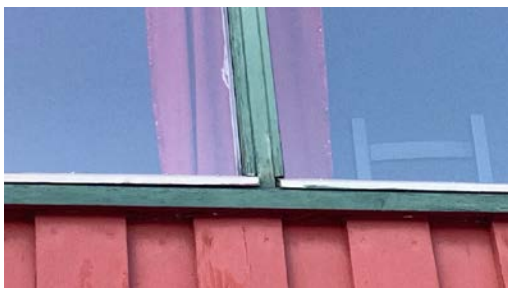
Eksempel på utvendig slitasje.
