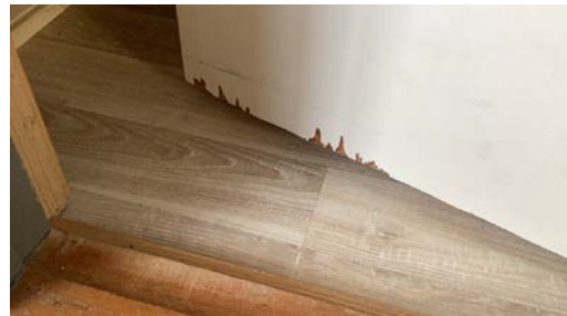
Eksempel på slitasje.
