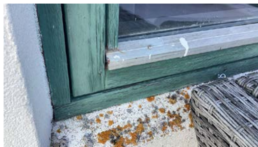
Eksempel på utvendig slitasje.
