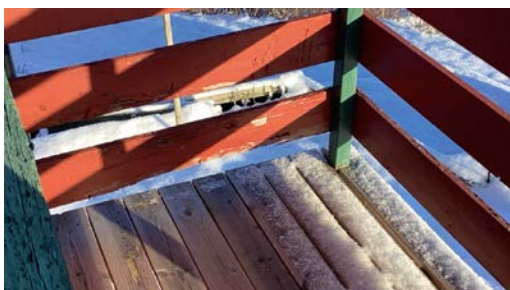
Råte på rekkverkskledning på balkong.
