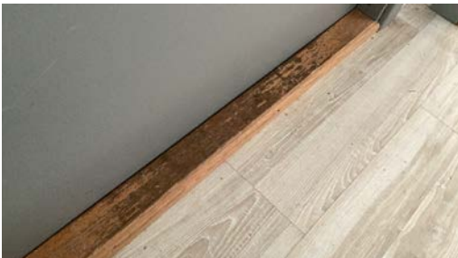
Eksempel på slitasje.
