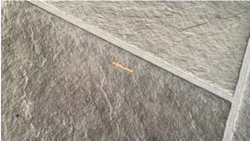
Hakk i gulv på kjøkken.
