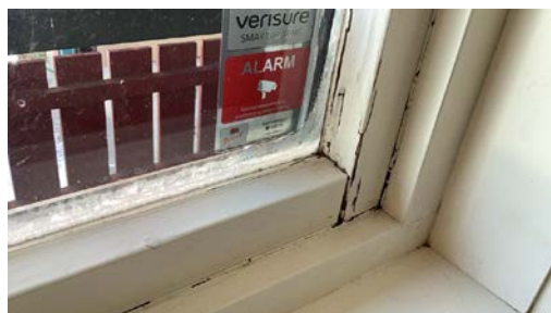
Eksempel på innvendig slitasje.
