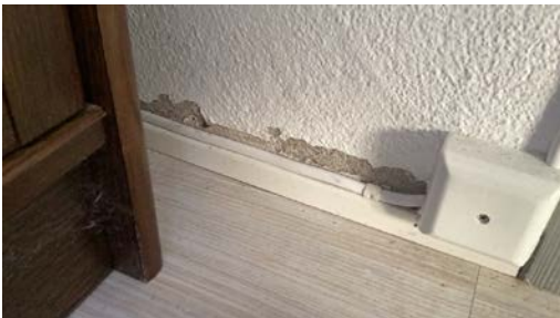
Avskaling på murvegg.
