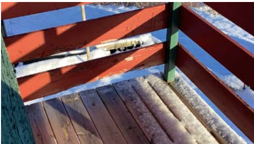
Råte på rekkverkskledning på balkong.
