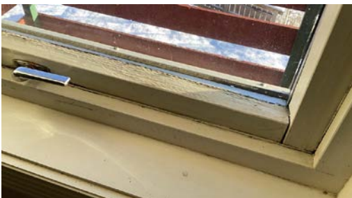
Eksempel på innvendig slitasje.
