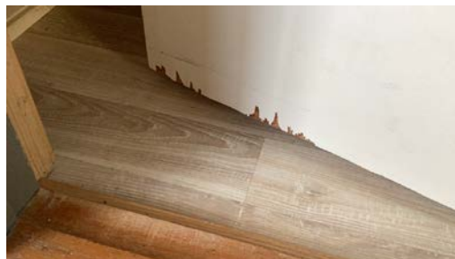
Eksempel på slitasje.
