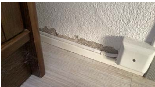
Avskaling på murvegg.
