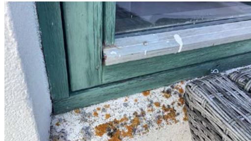
Eksempel på utvendig slitasje.
