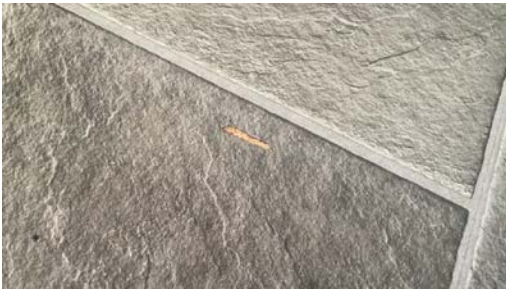
Hakk i gulv på kjøkken.
