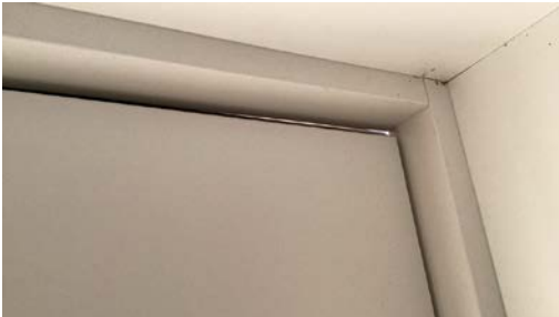
Dør i sokkeletasje tetter ikke helt øverst på dør.
