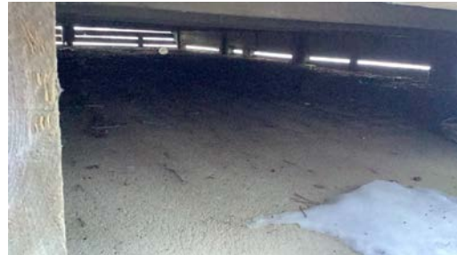
Det er ikke tekking over rom under veranda.
