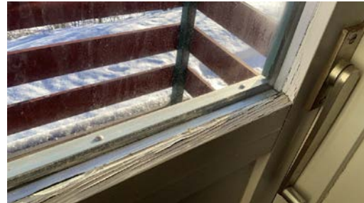
Slitasje på balkongdør.
