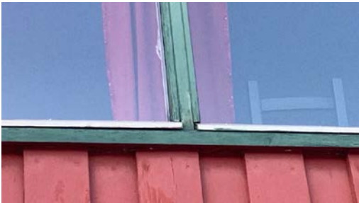
Eksempel på utvendig slitasje.
