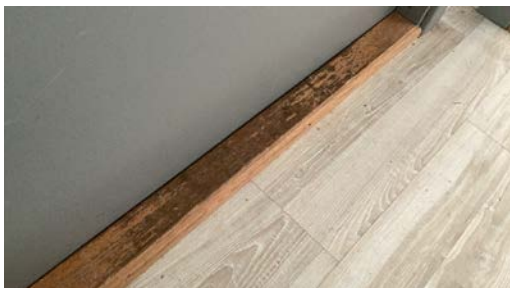
Eksempel på slitasje.
