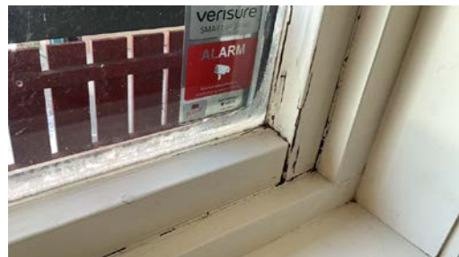
Eksempel på innvendig slitasje.
