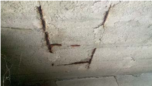
Avskaling og synlig armering under hovedveranda.
