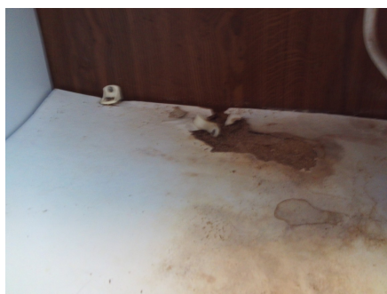
Eldre fuktskader i benkeskap under vaskekum.
