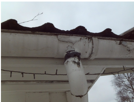
Eldre slitte rewnner i fra byggeåret
