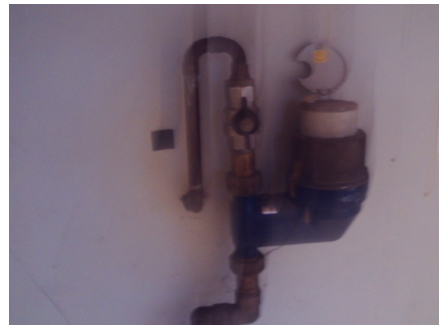
Innvendig stoppekran med vannmåler er plassert på vaskerommet.
