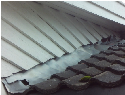
Utett beslag i overgang takflate og vegg.
