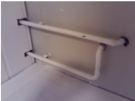
Kobberrør i fra byggeåret.
