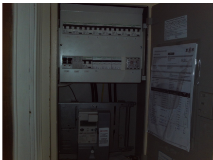
Sikringsskapet er plassert i vindfang.
