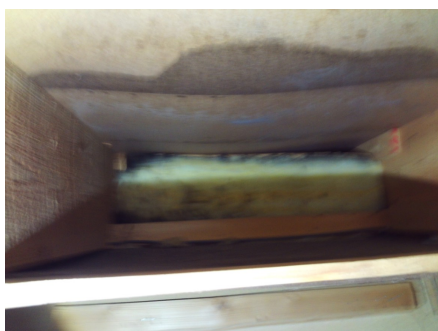
Luftespalter er klemte i sammen på midten
