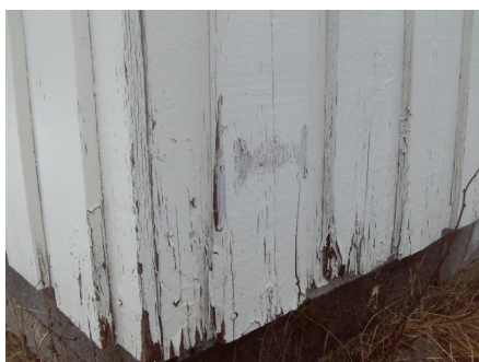
Råteskader på garasje. (taknedløp mangler)
