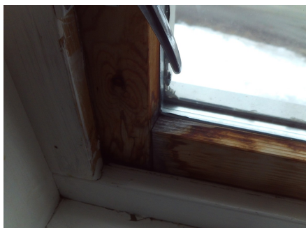
En del innvendige kondensmerker.
