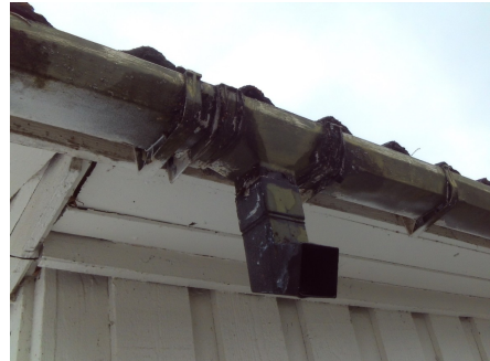
Alitte plastrenner på garasje uten nedløp.
