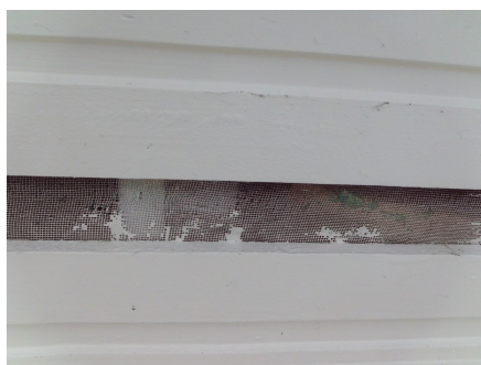
Bra med luftespalter i gesimser.
