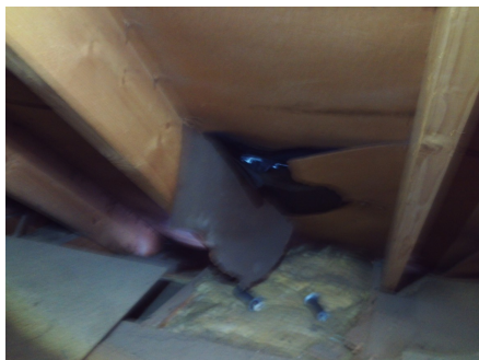
Skade på undertaket på knekott.
