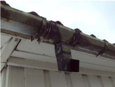
Alitte plastrenner på garasje uten nedløp.
