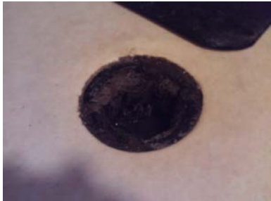
Eldre opprinnelig sluk
