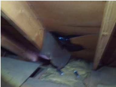
Skade på undertaket på knekott.
