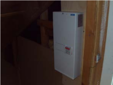
Hovedinntak på kott på loftet
