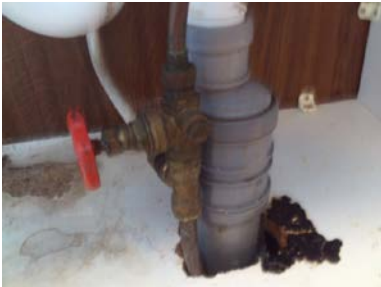
Avløpsrør i kjøkkenbenken.
