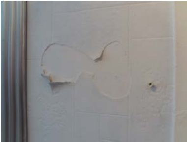
Skader på våtromstapet.
