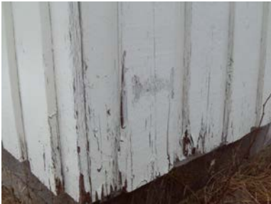
Råteskader på garasje. (taknedløp mangler)
