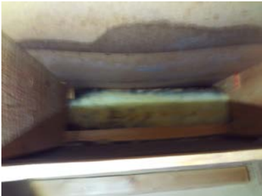
Luftespalter er klemt i sammen på midten
