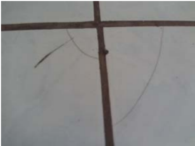
Noen sprekkker i gulvflis
