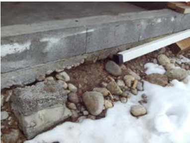
Masser har glidd ut ved garasje.
