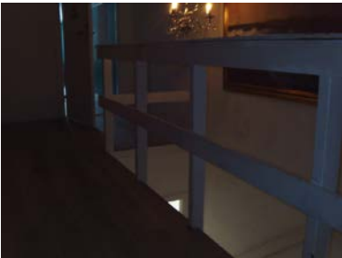
Store åpninger i rekkverk.
