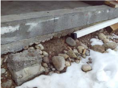
Masser har glidd ut ved garasje.
