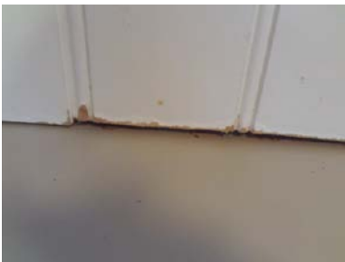
Trykket noe fukt opp i veggplater ved benkeplate.
