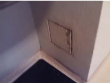
Sotluke på vaskerom.
