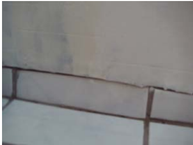
Oppkantfliser er løse mot yttervegg.
