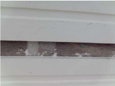
Bra med luftespalter i gesimser.
