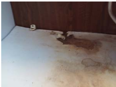
Eldre fukskader i benkeskap under vaskeum.
