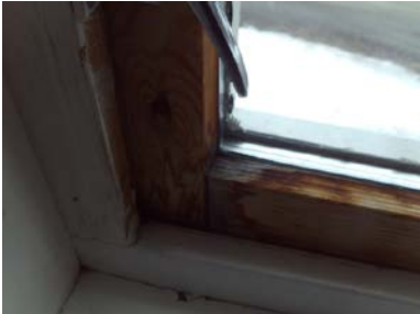
En del innvendige kondensmerker.
