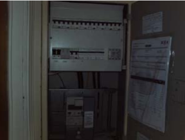
Sikringsskapet er plassert i vindfang.
