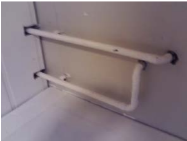
Kobberrør i fra byggeåret.
