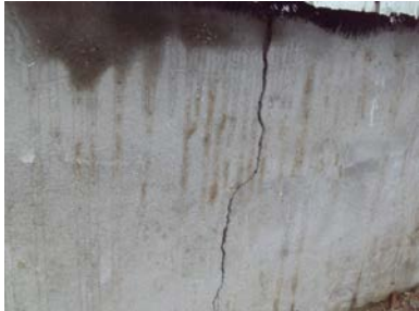
Sprekk i ringmur på endeveggen ved ene soverommet.
