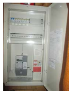
Sikringsskapet er plassert i gangen.
