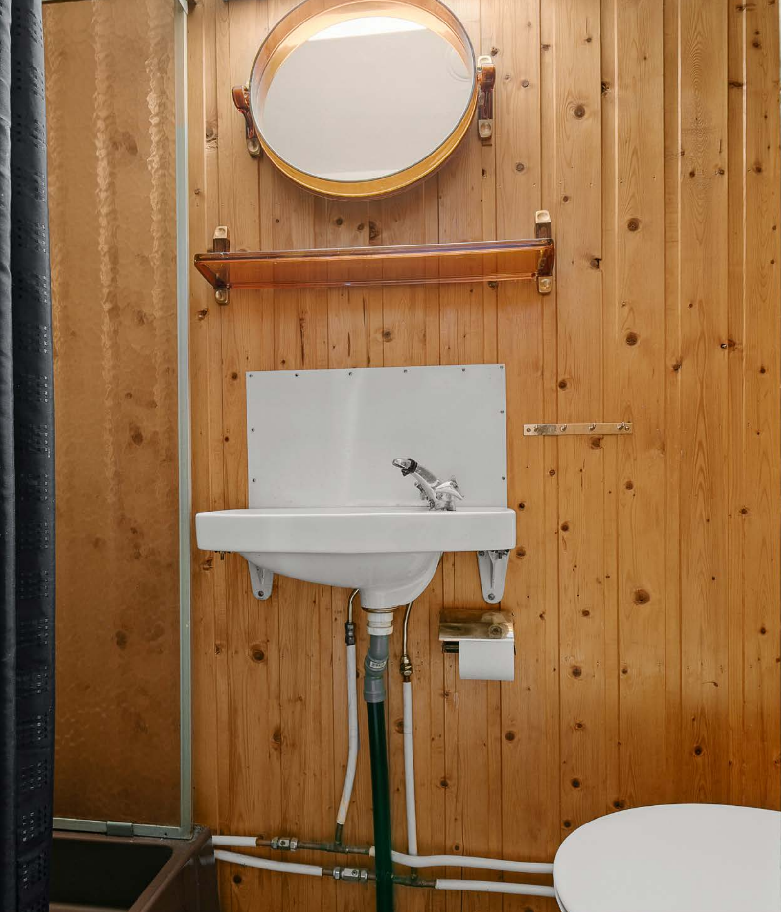
Badet i 2. etasje er innredet med dusjkabinett, vask, speil og toalett.
