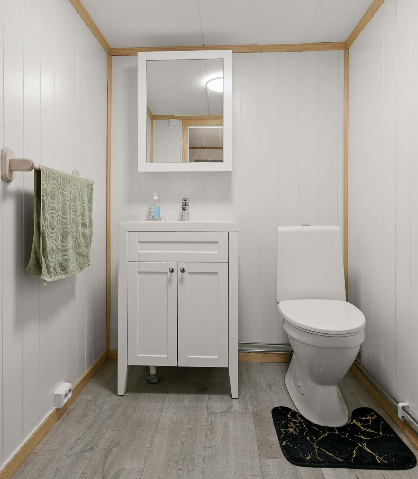
Toalettrommet i kjelleren består av benk med vask, overskap med speil og toalett.
