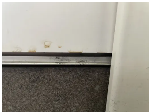
Manglende silikonefuge mellom baderomsplater og sokkelprofil.
