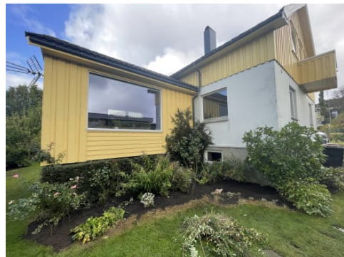
Foto viser vegetasjon inntil konstruksjoner.
