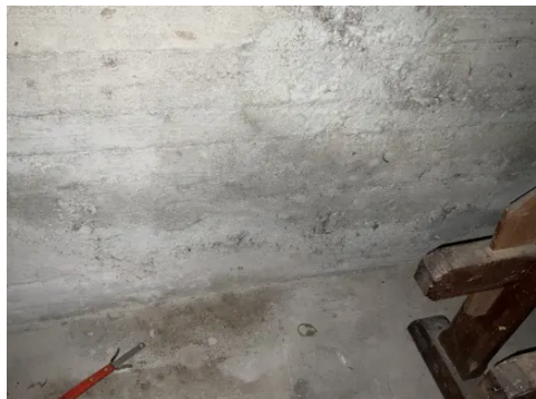
Foto viser saltutslag rundt dør, stedvis noe fuktutslag i nedre kant av mur i kjeller.
