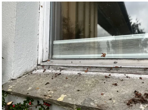
Foto viser eksempel på råte i karm/ ramme og manglende beslag ved innpussing.
