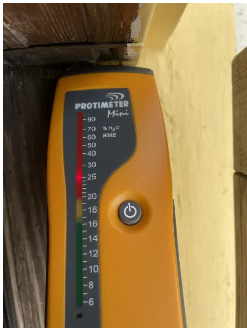
Forhøyet fuktnivå i karm på vindu.
