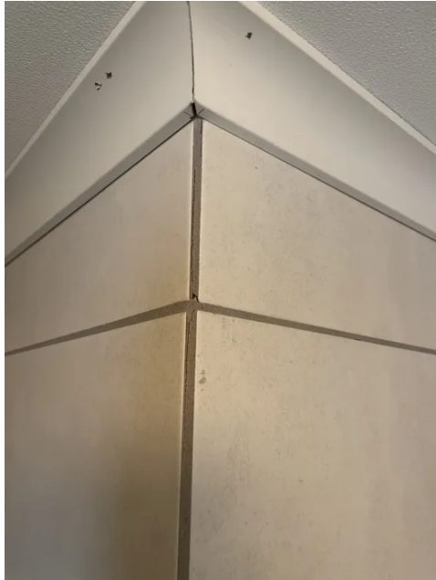
Sprekk i flisfuge.
