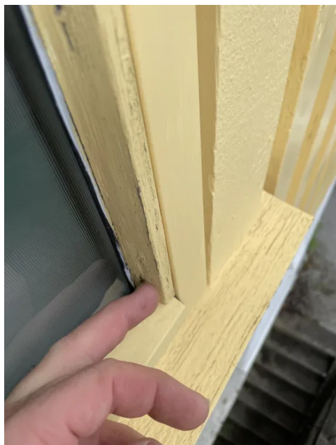
Råte i glasslister.
