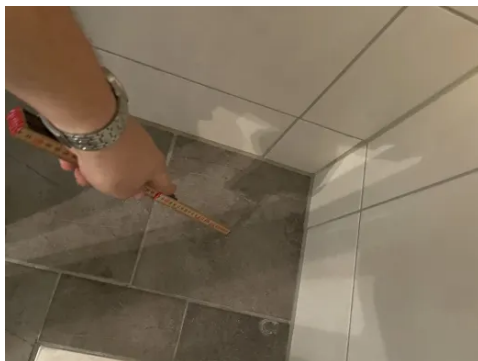
Markerer hvor bom under flis er påvist på gulv i dusjsone.
